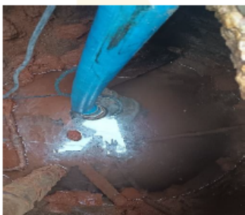
Pozo 1 no se observa mangueras ni tuberías que capten agua, ni de ingreso de la misma
