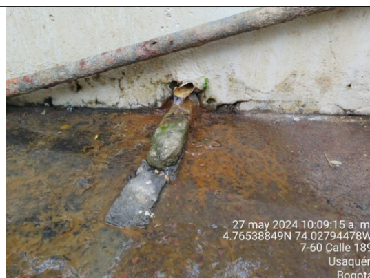
Foto No. 6. Infiltración de agua proveniente del lago
